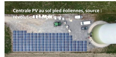
Centrale PV au sol Oxelaère, Flandres. Photo La VDN
